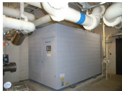
附属図書館他冷温水発生機更新
